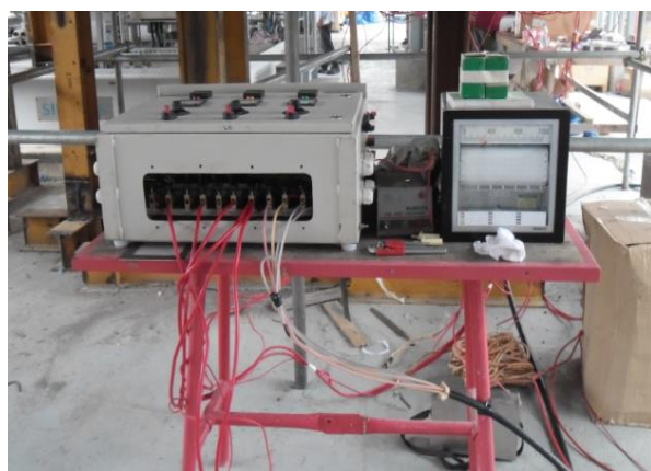
Fig.19: Local PWHT controller
